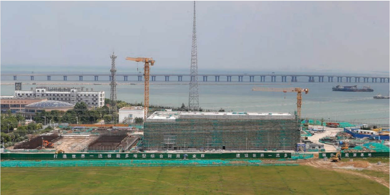
田湾核电厂蒸汽能源供应项目 (图片: 中核江苏核电站)
